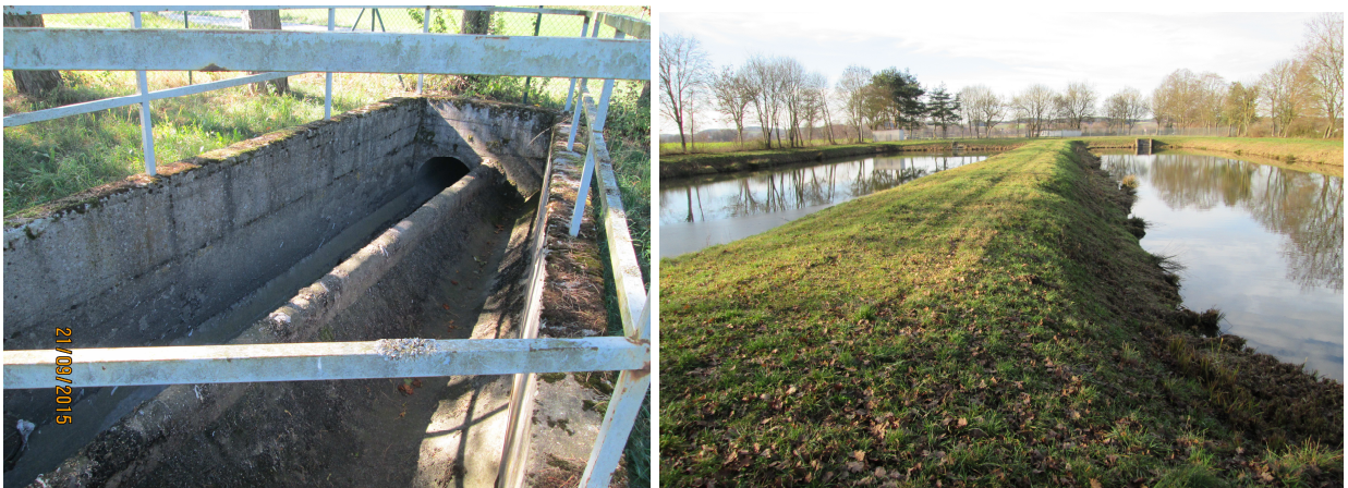
Abbildung 3-5: Regenüberlaufbauwerk und Oxidationsteiche in Puch
