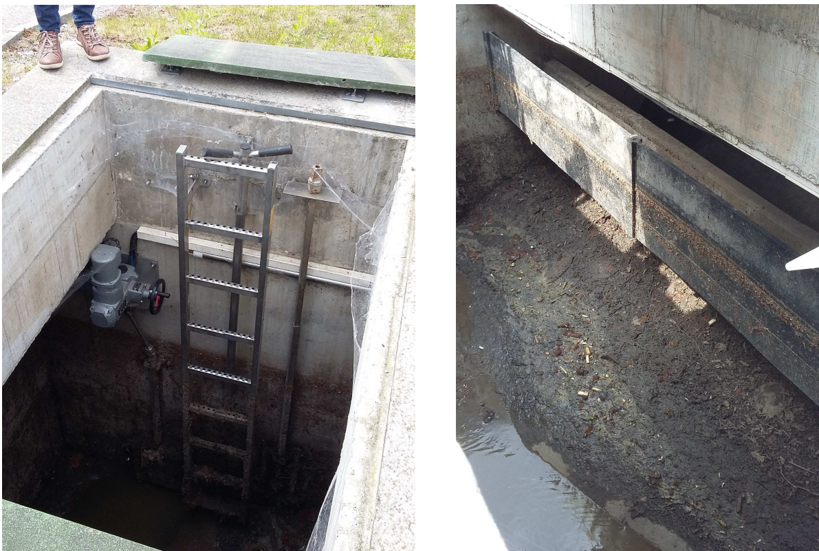
Abbildung 3-2: Elektroschieber und Schwelle mit Tauchwand am B02
