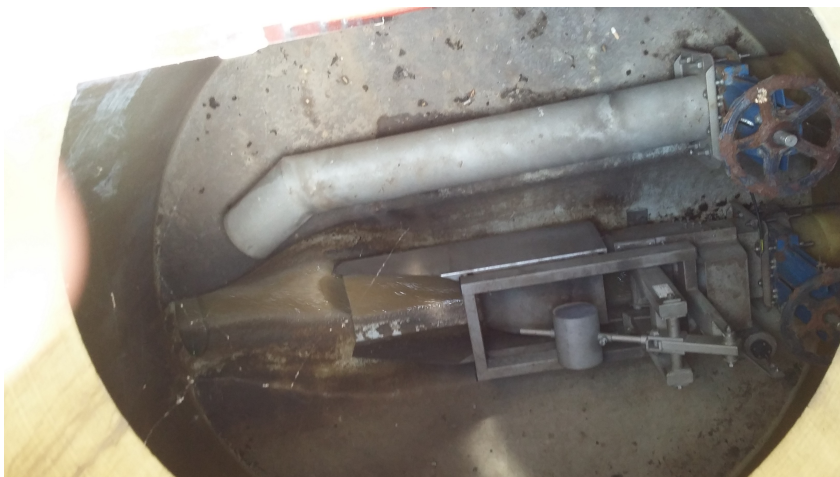
Abbildung 3-1: Hydroslide am B01
