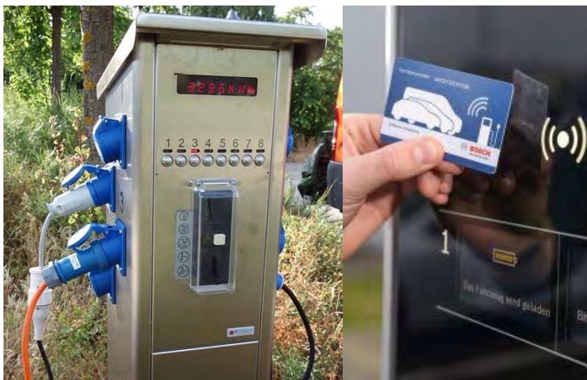
Abb. 90: Ladesäule und Bezahlvorgang an einer Ladesäule (Symbolbild).
