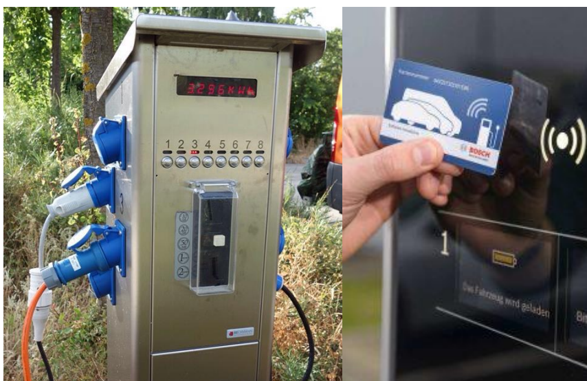
Abb. 90: Ladesäule und Bezahlvorgang an einer Ladesäule (Symbolbild).
