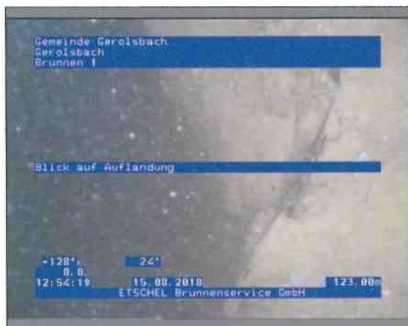
Foto: 1_1_30_15082018_125230_A.JPG 123m, Blick auf Auflandung
