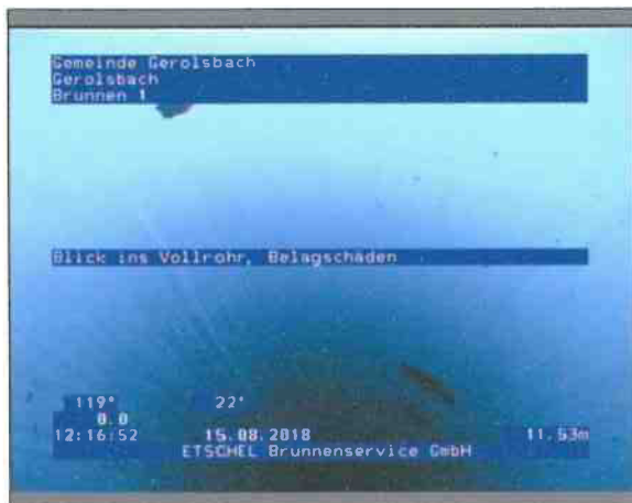
Foto: 1_1_7_15082018_121511_A.JPG 11,53m, Blick ins Vollrohr / Belagschäden
