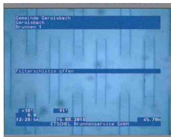
Foto: 1_1_17_15082018_122715_A.JPG 45,7m, Filterschlitz offen
