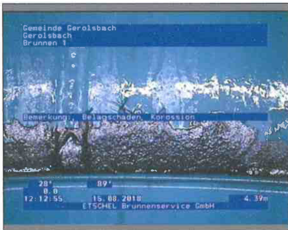
Foto: 1_1_3_15082018_121114_A.JPG 4,39m, Bemerkung: / Belagschaden, Korrosion
