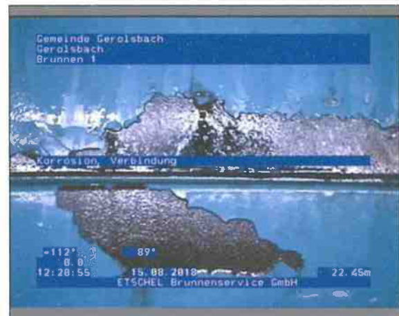
Foto: 1_1_10_15082018_121914_A.JPG 22,45m, Korrosion / Verbindung
