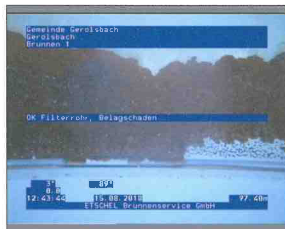
Foto: 1_1_26_15082018_124203_A.JPG 97,4m, OK Filterrohr / Belagschaden
