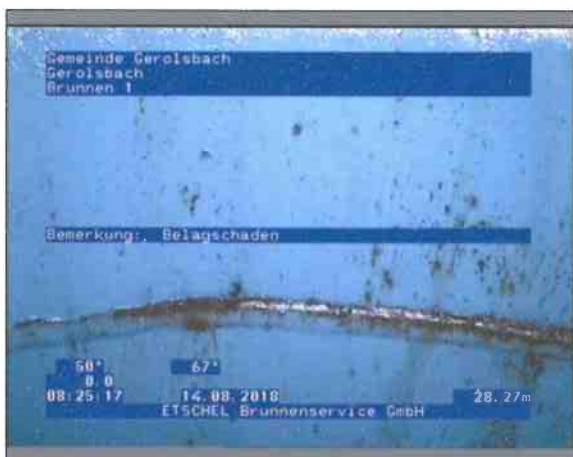
Foto: 1_1_9_14082018_082339_A.JPG 28,27m, Bemerkung: / Belagschaden
