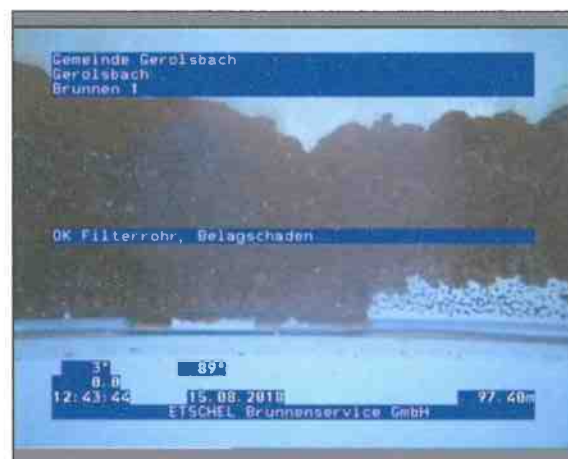
Foto: 1_1_26_15082018_124203_A.JPG 97,4m, OK Filterrohr / Belagschaden
