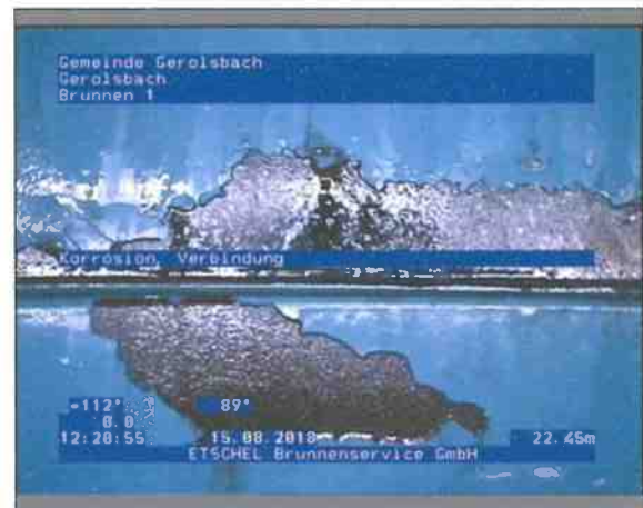
Foto: 1_1_10_15082018_121914_A.JPG 22,45m, Korrosion / Verbindung
