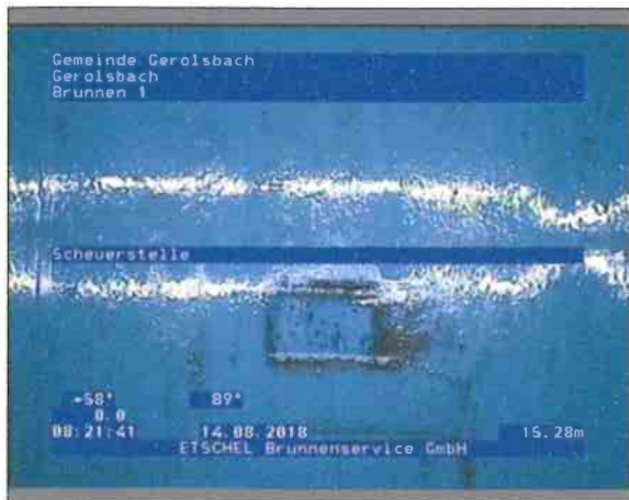
Foto: 1_1_7_14082018_082002_A.JPG 15,28m, Scheuerstelle
