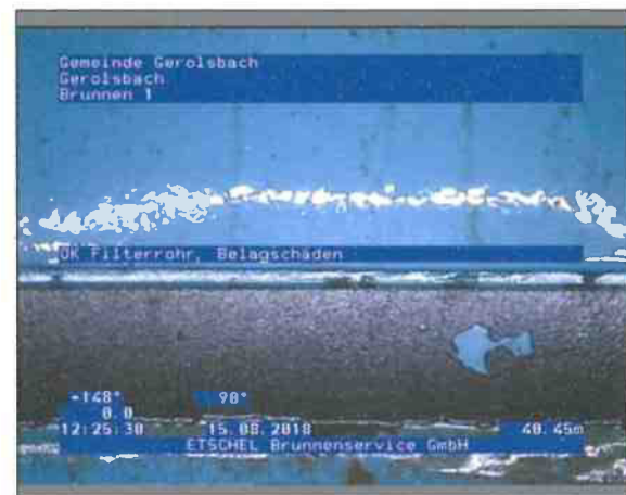
Foto: 1_1_14_15082018_122349_A.JPG 40,45m, OK Filterrohr / Belagschaden
