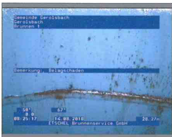
Foto: 1_1_9_14082018_082339_A.JPG 28,27m, Bemerkung: / Belagschaden
