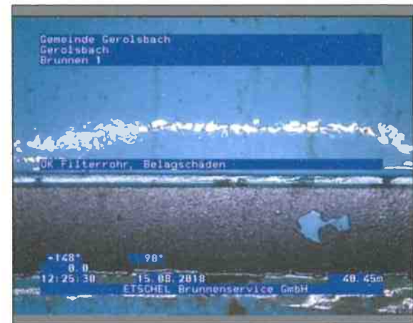
Foto: 1_1_14_15082018_122349_A.JPG 40,45m, OK Filterrohr / Belagschaden
