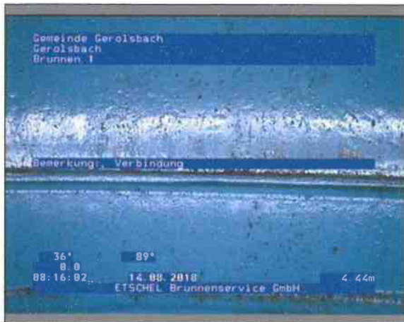
Foto: 1_1_3_14082018_081423_A.JPG 4,44m, Bemerkung: / Verbindung
