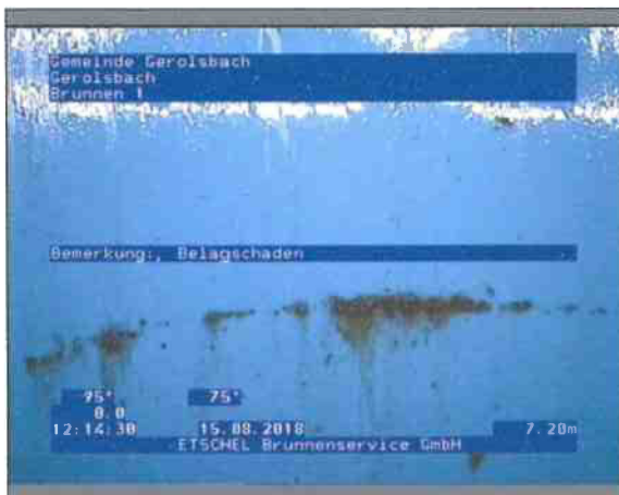
Foto: 1_1_5_15082018_121249_A.JPG 7,2m, Bemerkung: / Belagschaden
