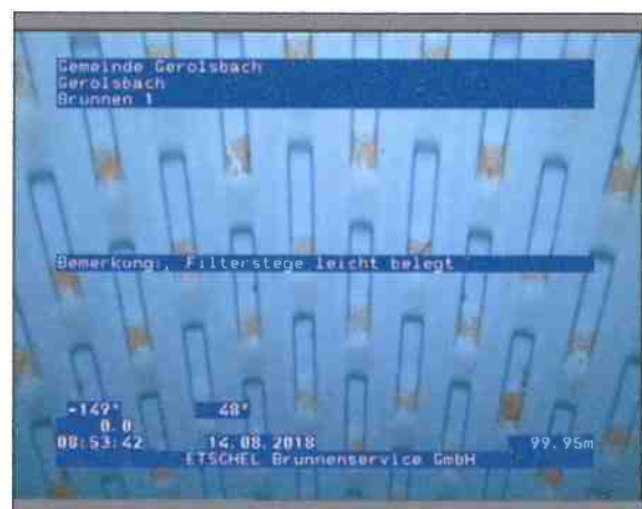
Foto: 1_1_24_14082018_085203_A.JPG 99,95m, Bemerkung: / Filterstege leicht belegt
