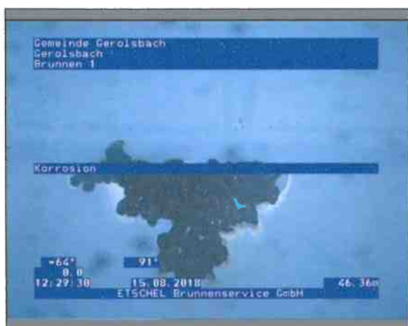
Foto: 1_1_18_15082018_122749_A.JPG 46,36m, Korrosion
