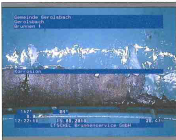
Foto: 1_1_11_15082018_122029_A.JPG 28,43m, Korrosion
