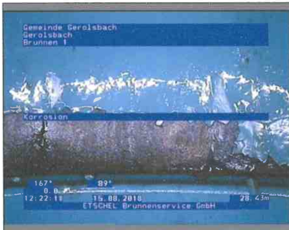
Foto: 1_1_11_15082018_122029_A.JPG 28,43m, Korrosion
