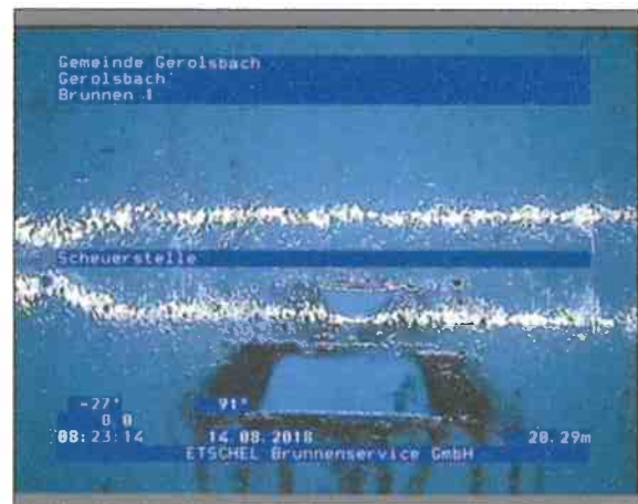
Foto: 1_1_8_14082018_082136_A.JPG 20,29m, Scheuerstelle
