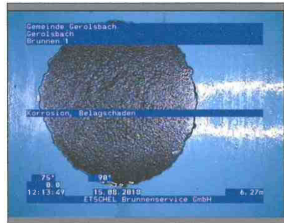
Foto: 1_1_4_15082018_121208_A.JPG 6,27m, Korrosion / Belagschaden
