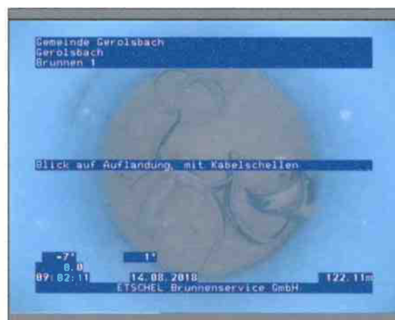
Foto: 1_1_29_14082018_090032_A.JPG 122,11m, Blick auf Aufwindung / mit Kabelschellen
