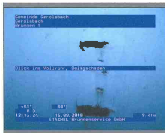
Foto: 1_1_6_15082018_121342_A.JPG 9,41m, Blick ins Vollrohr / Belagschaden
