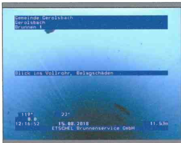
Foto: 1_1_7_15082018_121511_A.JPG 11,53m, Blick ins Vollrohr / Belagschäden
