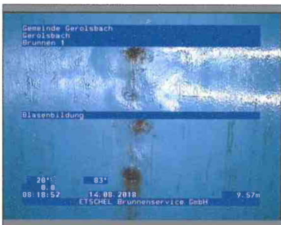
Foto: 1_1_5_14082018_081713_A.JPG 9,57m, Blasenbildung
