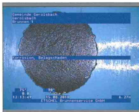
Foto: 1_1_4_15082018_121208_A.JPG 6,27m, Korrosion / Belagschaden
