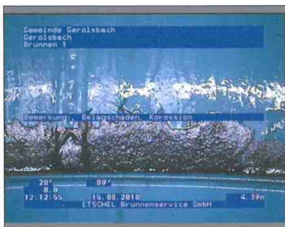
Foto: 1_1_3_15082018_121114_A.JPG 4,39m, Bemerkung: / Belagschaden, Korrosion
