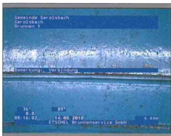
Foto: 1_1_3_14082018_081423_A.JPG 4,44m, Bemerkung: / Verbindung
