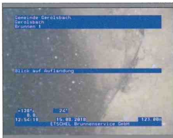
Foto: 1_1_30_15082018_125230_A.JPG 123m, Blick auf Auflandung
