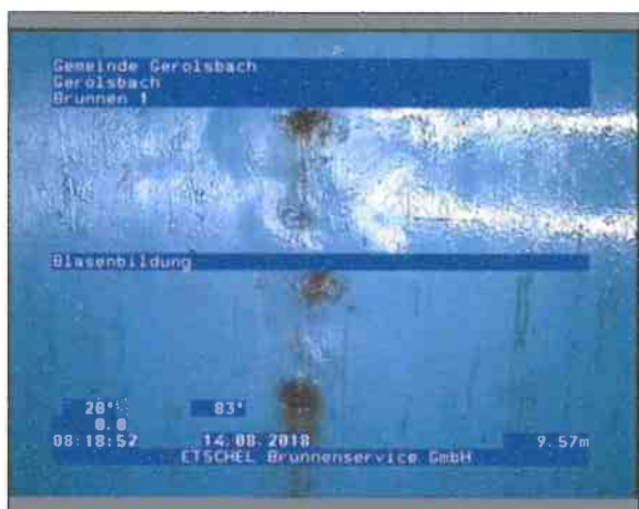
Foto: 1_1_5_14082018_081713_A.JPG 9,57m, Blasenbildung
