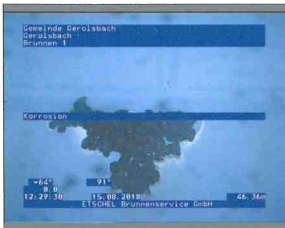
Foto: 1_1_18_15082018_122749_A.JPG 46,36m, Korrosion
