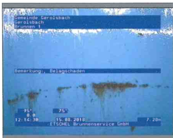
Foto: 1_1_5_15082018_121249_A.JPG 7,2m, Bemerkung: / Belagschaden
