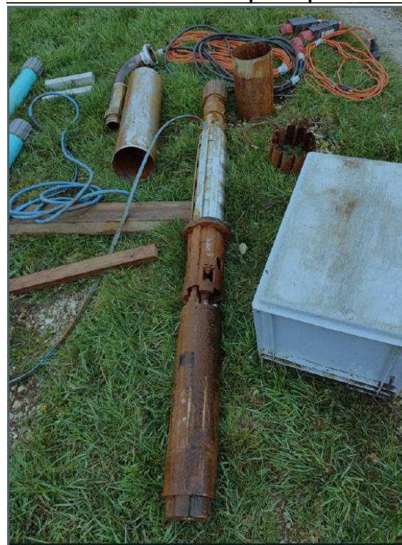
Verockerung an der Unterwasserpumpe
