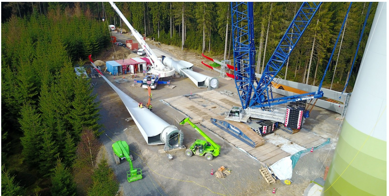
Abbildung 7: Kranstellfläche und temporäre Montageflächen während des Aufbaus einer Windenergieanlage Quelle: © Mark-E/Carsten Engel (2017)
