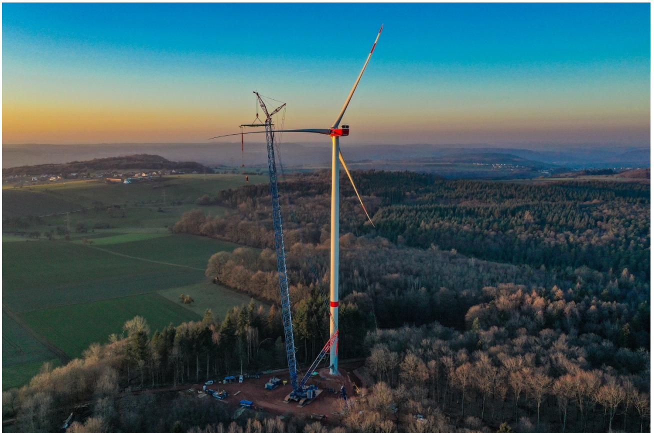
Abbildung 37: Anlagenerichtung im Windpark Wintersteinchen, Landkreis Merzig-Wadern (Saarland)
