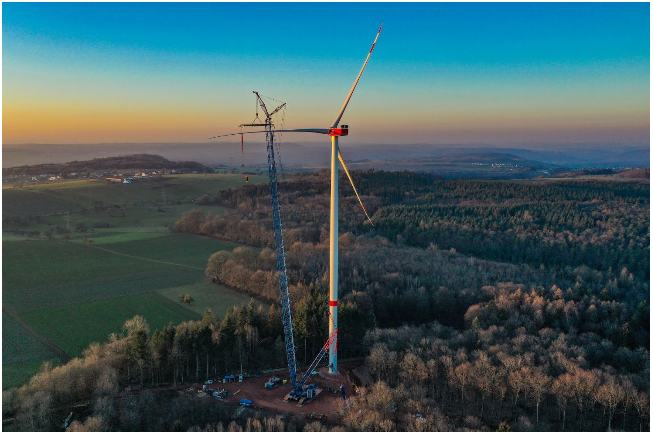
Abbildung 37: Anlagenerichtung im Windpark Wintersteinchen, Landkreis Merzig-Wadern (Saarland)
