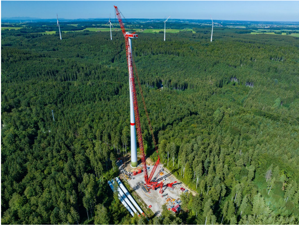
Abbildung 19: Anlagenerrichtung im Bürgerwindpark Fuchstal, Landkreis Landsberg am Lech (Bayern) Quelle: © Ingenieurbüro Sing (2024)
