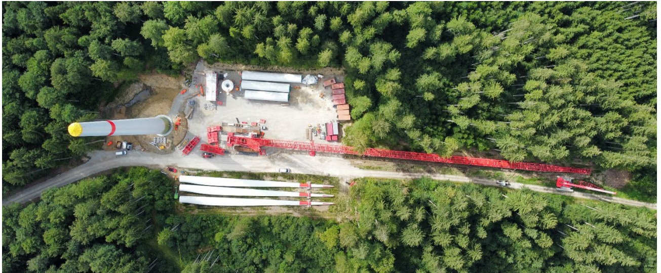
Abbildung 9: Lagerflächen und Fläche für den Aufbau des Kranauslegers zur Errichtung der Windenergieanlage Quelle: © Ingenieurbüro Sing (2024)
