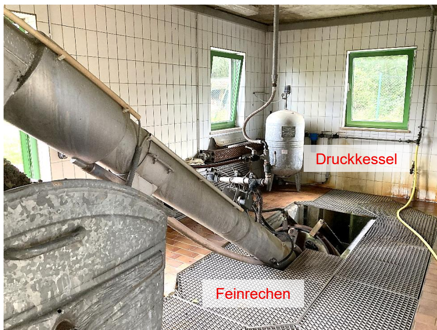
Abbildung 3-6: Rechanlage der Kläranlage Hohenwart (BBI INGENIEURE GMBH, Aufnahme vom 09.08.2023)
