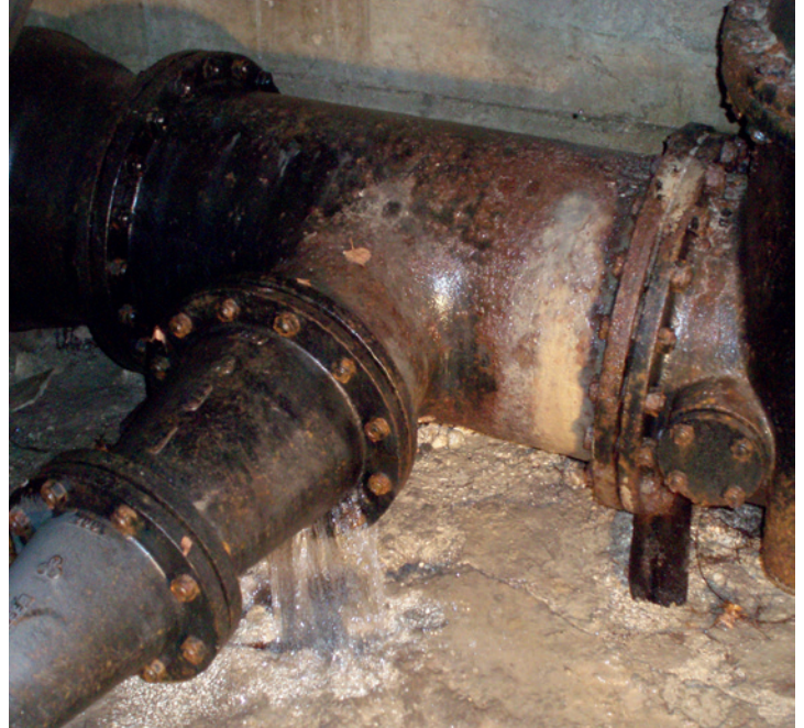
Durch Korrosion werden Leitungen schleichend zerstört.
